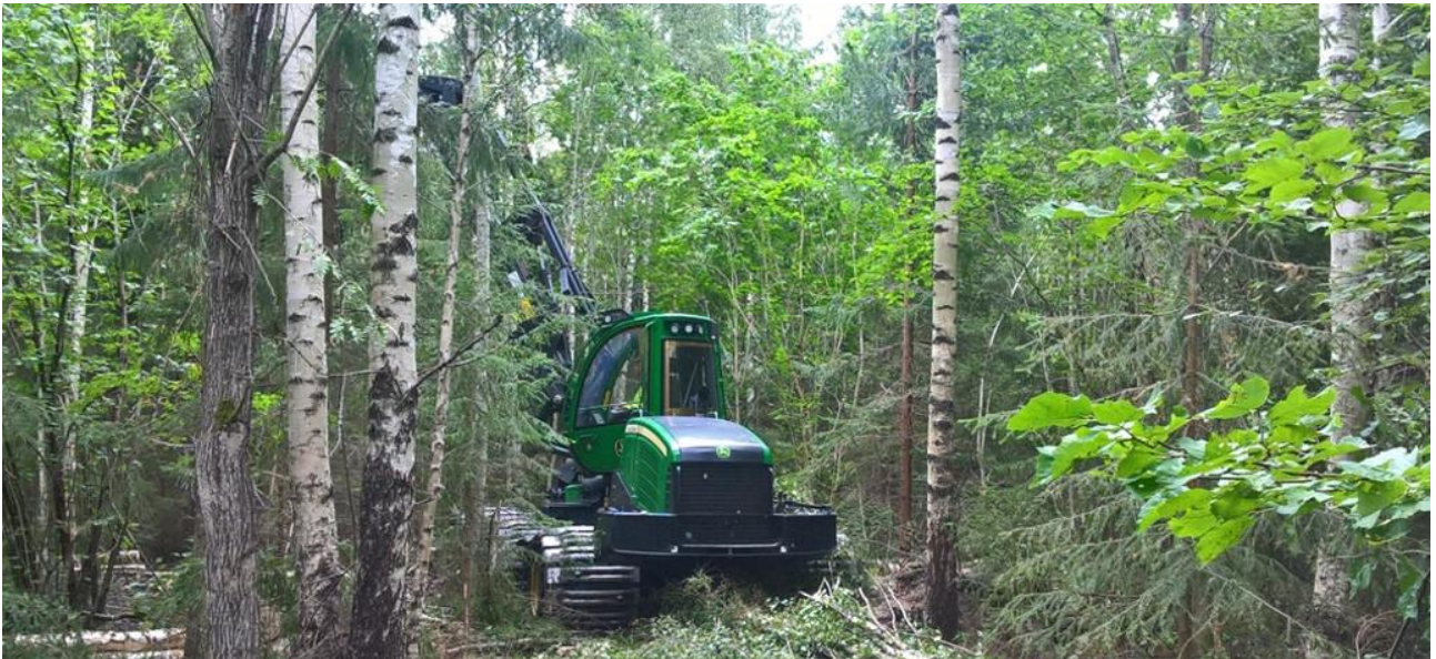
Kuva 1. Pähkinälehdon hoitoa kantavalla maalla syyskuun alussa lintujen pesimäajan ulkopuolella. Tämä talousmetsänä ollut lehtokohde päättyi hoitotöiden jälkeen METSO-ohjelman pysyvän suojeluun.
