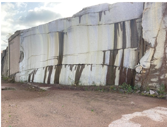
Kuva 1. Viborgiittikallion vettä johtavia halkeamia (Lammaskallio, tarvekivilouhos, Virolahti 1.10.2023 ).
